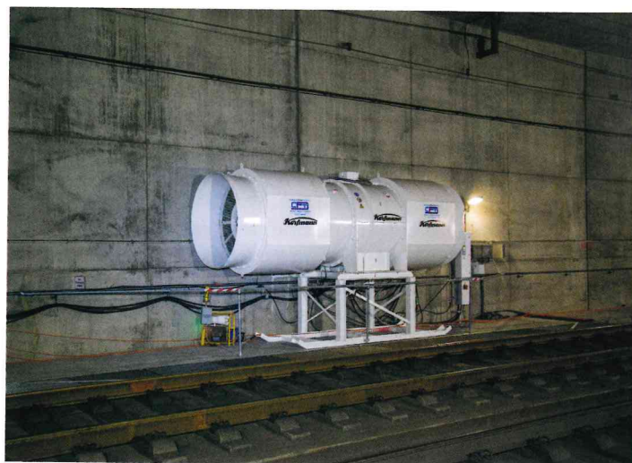
Bild 7: Strahllüfter im Tunnelrandweg
